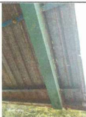
Foto 3: Estructura metálica de cubierta oxidada
