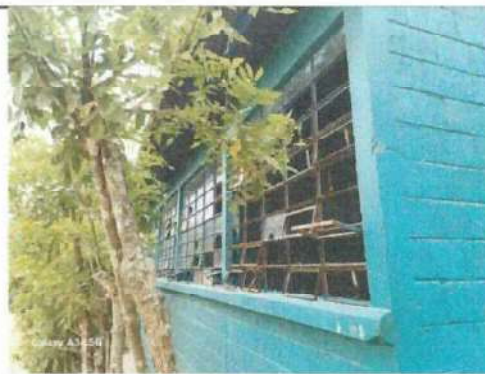
Foto 4: Vidrios de ventana quebradas
