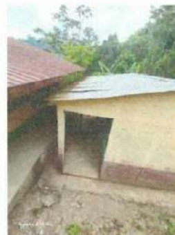
Foto 2: Paredes exterior de aula 2 con deterioro
